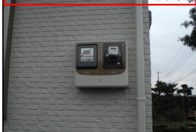
平成29年3月20日電力量計設置後
