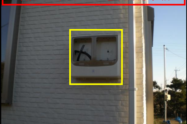
平成29年3月1日電力量計設置前
