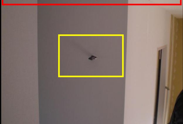
平成29年3月1日分パワコン設置前
