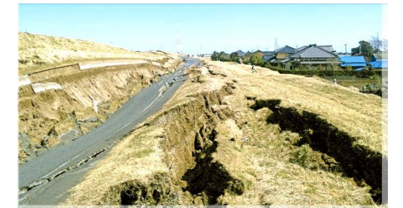
東日本大震災直後。利根川堤防の被害は広範にわたった。
